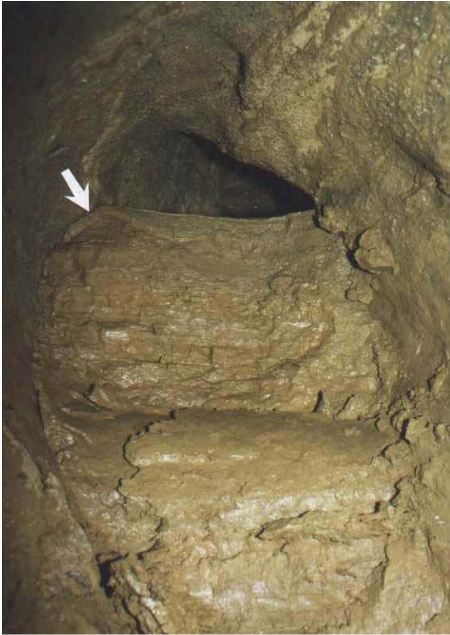
Bild 5: Sedimentverfüllte Druckröhre im Parallelschacht. Der Pfeil zeigt das dunkle Sedimentband der jüngsten Ablagerung.
